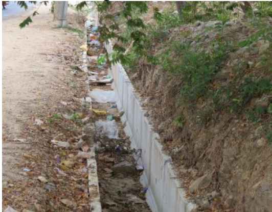
Gambar 2.21 Kedudukan Longkang Dan Aras Tanah Yang Tidak Sesuai
