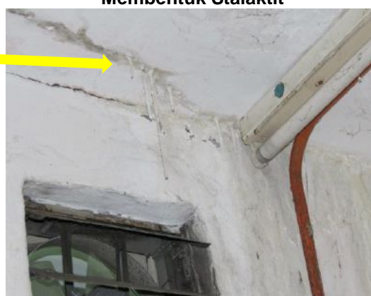
Gambar 4.20 Titisan Air Dari Lantai Tingkat Atas Yang Bocor Telah Membentuk Stalaktit
