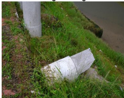
Gambar 2.40 Tembok Penahan Tiang Yang Tumbang
