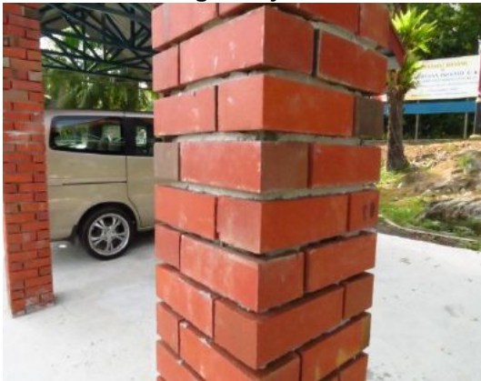
Gambar 2.17 Binaan Tiang Garaj Tidak Kemas
