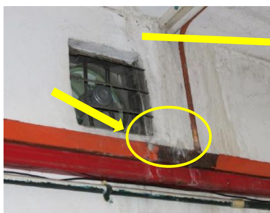
Gambar 4.19 Besi Paip Kabel Elektrik Berkarat Kesan Lelehan Air
