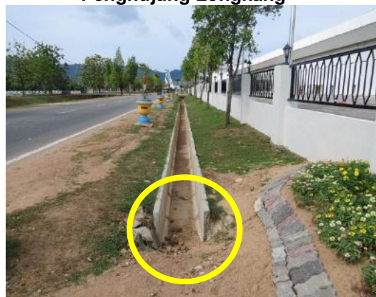
Gambar 2.6 Tiada Sump Dibina Di Penghujung Longkang
