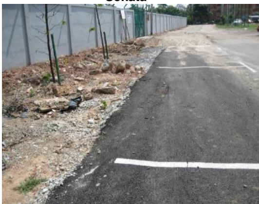
Gambar 2.13 Permukaan Jalan Yang Diturap Tidak Sekata
