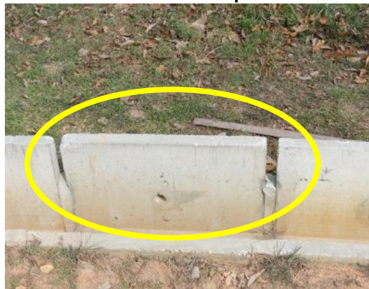
Gambar 2.24 Lepaan Simen Pada Penyambungan U Drain Tidak Sempurna
