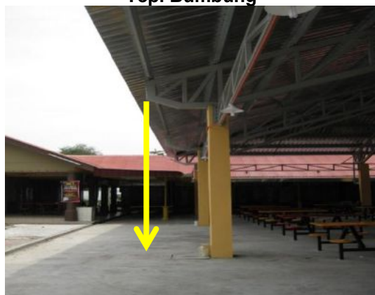
Gambar 2.3 Gutter Tidak Dipasang Di Bahagian Tepi Bumbung
