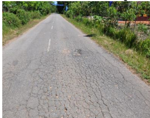
Gambar 1.9 Jalan Retak Dan Berlubang
