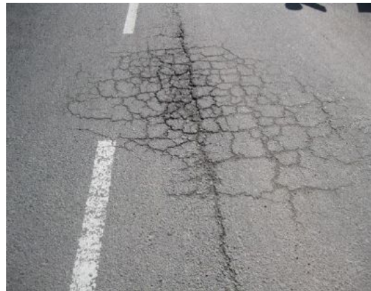
Gambar 2.12 Keretakan Di Permukaan Jalan
