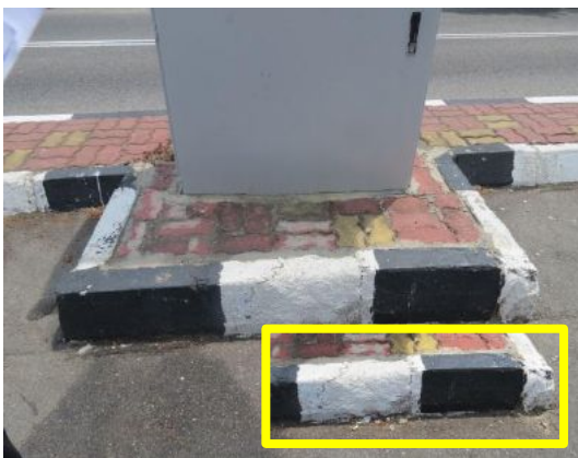
Gambar 2.19 Rekahan Pada Kerb Yang Baru Dibina
