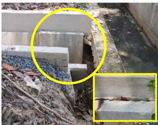
Gambar 2.7 Binaan U Drain Yang Tidak Sempurna
