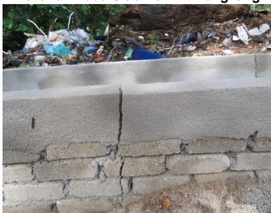
Gambar 2.25 Rekahan Pada Slab Konkrit Longkang
