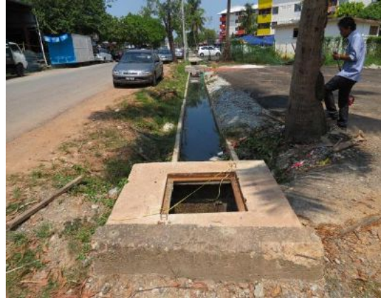
Gambar 2.16 Sump Tidak Ditutup
