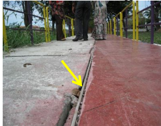
Gambar 2.10 Papan Acuan (Formwork) Pada Lantai Laluan Pejalan Kaki Tidak Ditanggalkan
