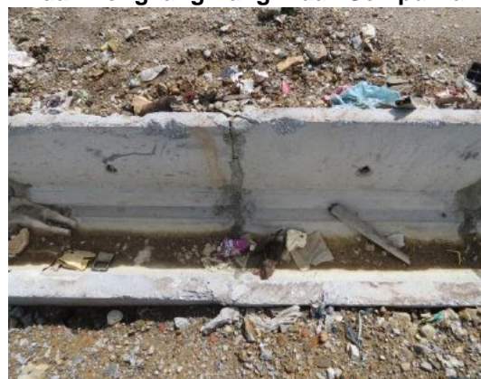
Gambar 2.26 Binaan Longkang Yang Tidak Sempurna
