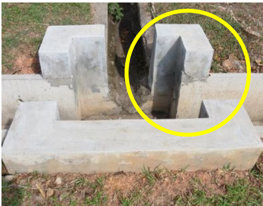
Gambar 2.23 Rekahan Pada Binaan Sump
