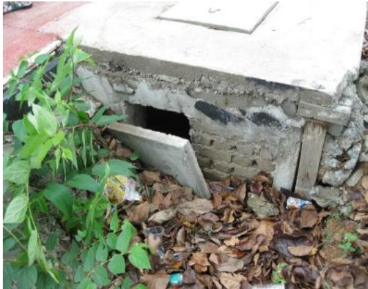
Gambar 2.9 Binaan Sump Yang Tidak Sempurna
